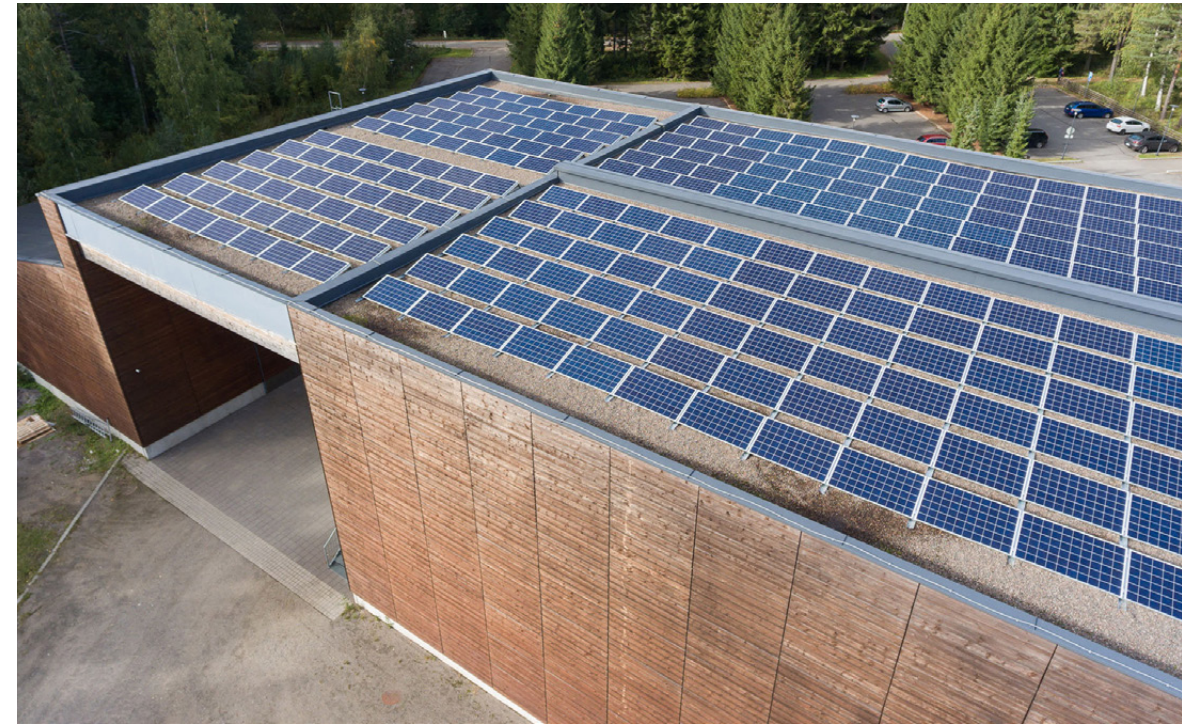
Aurinkopaneeleita Luston katolla. Kuva: Lusto.
